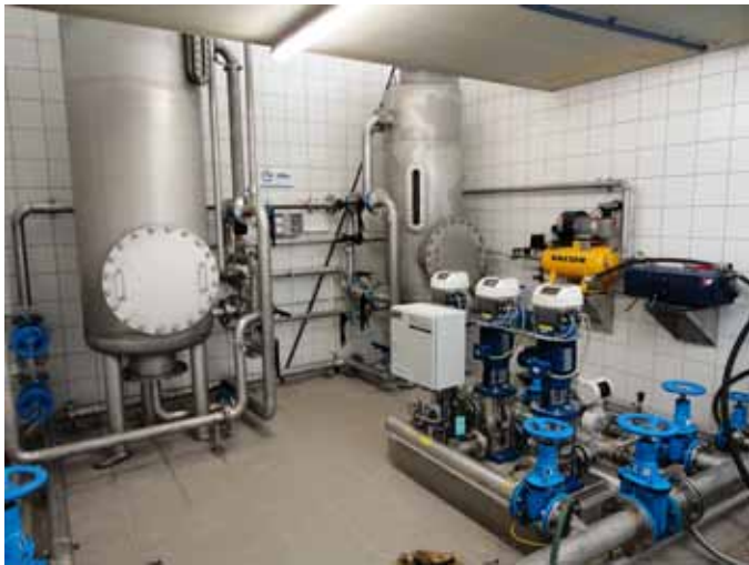
Technikraum im Hochbehälter
